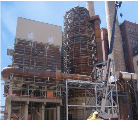
Nachdem die Module, Trichter, der Reaktor und die Verteiler installiert wurden, wird vor der Installation der Außenverkleidung die Isolierung aufgebracht.
