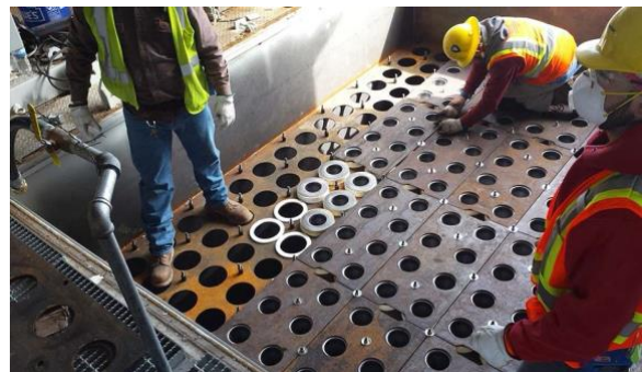
Wenn die Abdeckung entfernt ist, kann die Filterwartung in einer sicheren und belüfteten Umgebung durchgeführt werden.
