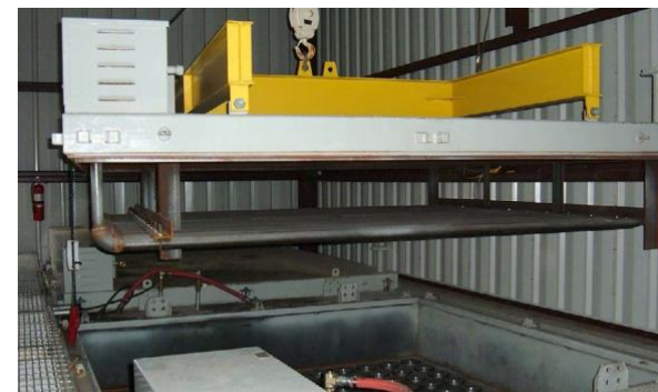
Ein Deckenkran wird verwendet, um das Abheben der Filterhauben für einen einfachen Zugang zu ermöglichen
